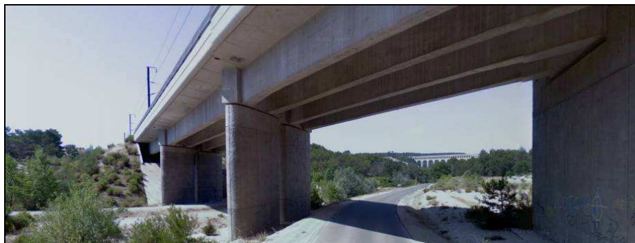
Photographie 46 : infrastructure liée au passage du T.G.V. devant l'aqueduc de Roquefavour en fond (vue depuis la RD 64)
